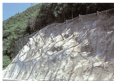
落石防護ネット
